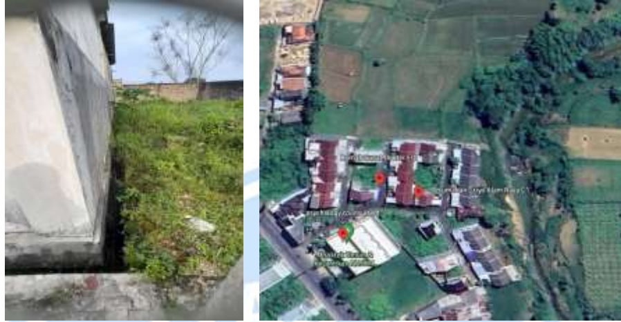
Gambar 1. 1 Pembuangan Akhir Saluran Drainase Terbuka dan Peta di Perumahan Griya Alam Raya C1 Kec. Batuan Kab. Sumenep. (Sumber: Dok. Perumahan Batuan, 2022 )
